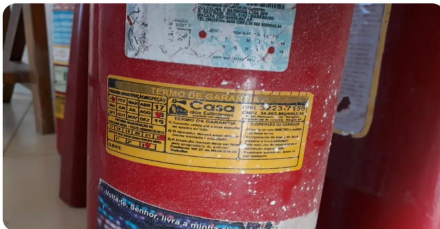
Foto feita por Conselho Regional de Medicina mostra mostra data de validade vencida de extintor do HES — Foto: CRM/Divulgação
